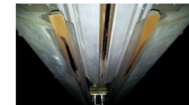
(b) 신축이음장치 편마모 현상
