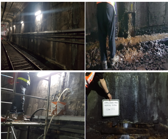
Fig.3 하선 내부 벽체 및 바닥 _ 누수 현황
