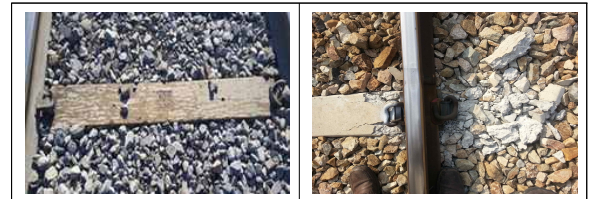
Fig. 1 초기망상균열 후 재료분리 심화
