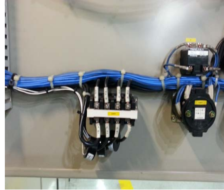
Fig 3. 52D2 특고압 배전반 클램프 CT 설치 사진
