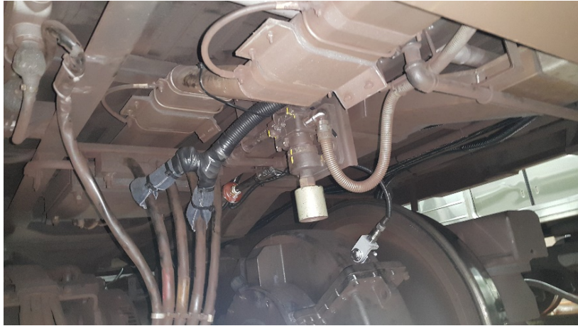
Fig. 3 전류센서를 설치한 모습
