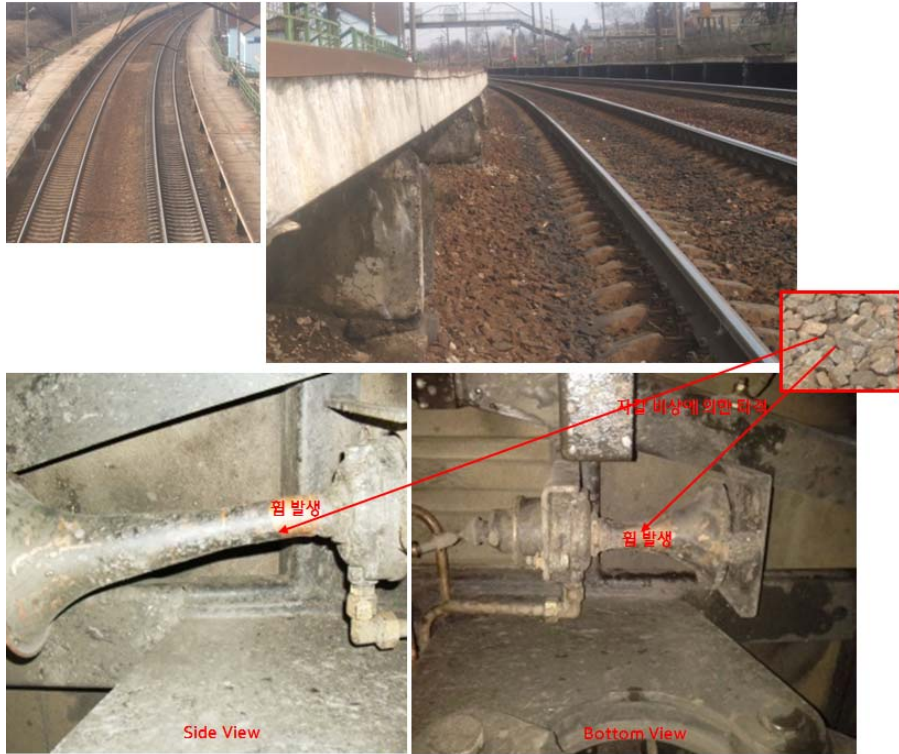
Fig. 3 선로 및 타격 손상 상태
