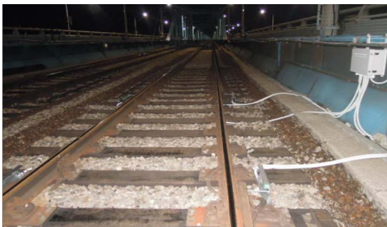
Fig 9 레일신축이음매 자동측정장치 설치완료
