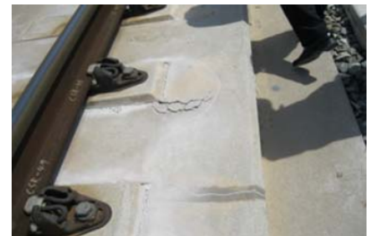
[파손균열 및 백화현상]
