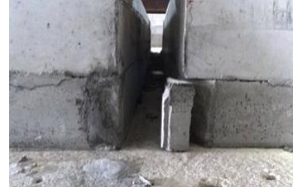
[충전층 파손 및 탈락]
