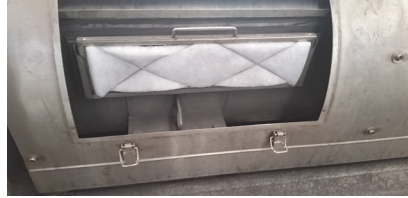
(4) 신선공기필터(개선) 취부 상태
